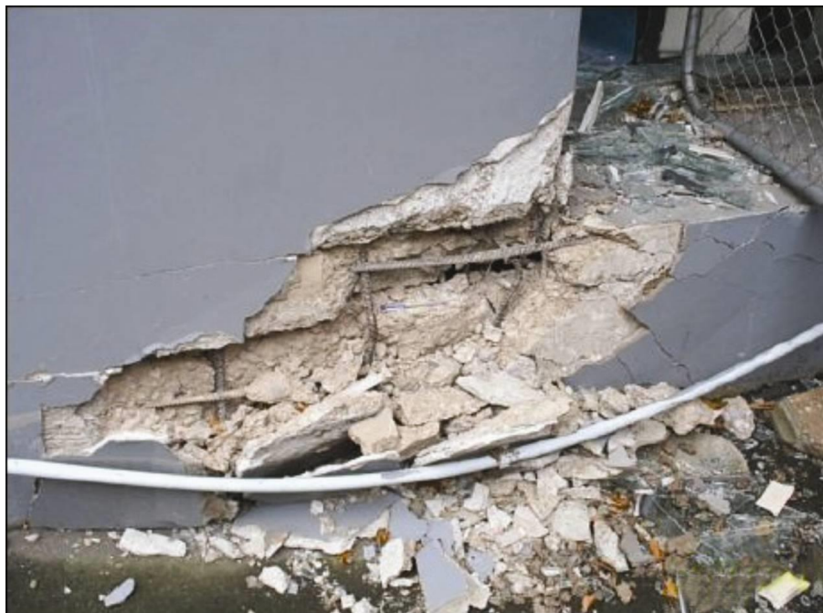
Figura 6. Fallo estructural del muro por flexión o cizallamiento, Christchurch Latimer square tomado de (Canterbury Earthquakes Royal Commision, 2012)
